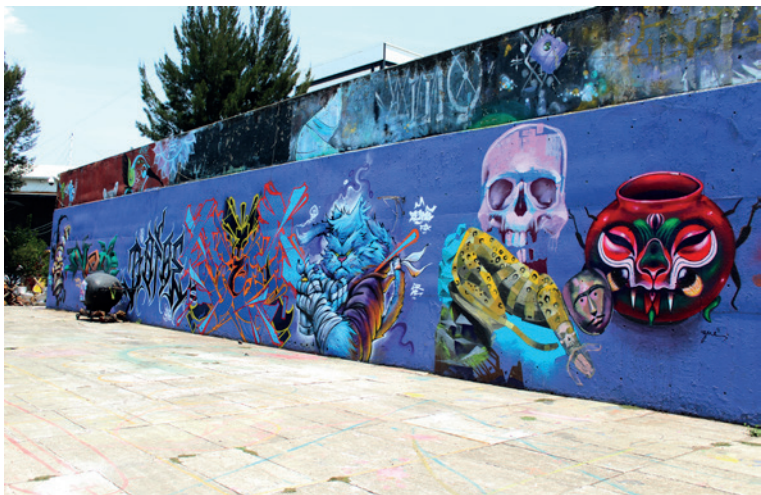
Imagen 29 Muro poniente de la nave principal, hacia el extremo norte, detalle 2. Moisés Falcon, abril de 2023
